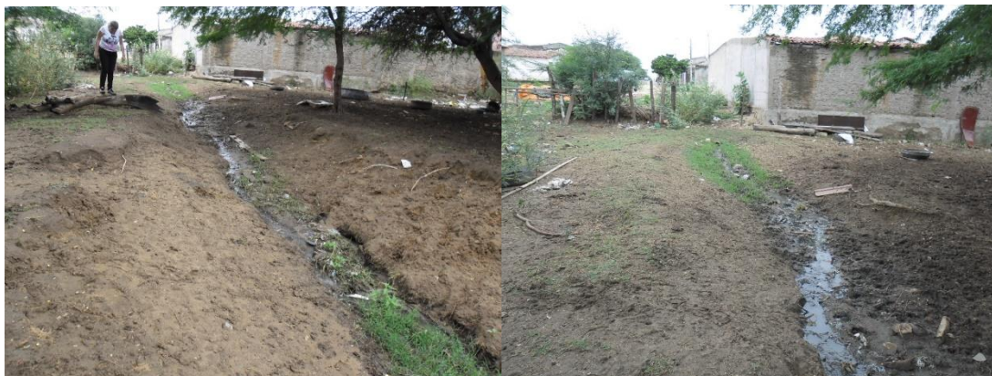
Figura 8- Solo erosivo – Margens rio Espinharas
