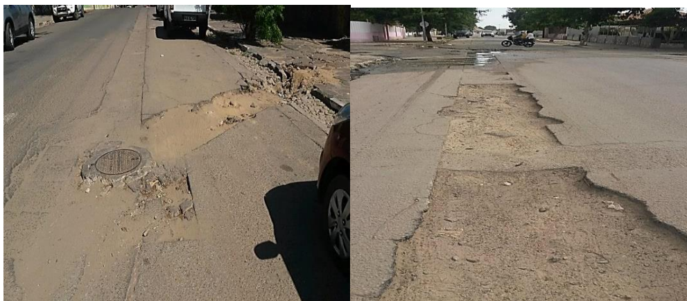
Figura 5 - Degradação do tapete asfáltico causando dificuldades numa moto-taxista e automobilista
