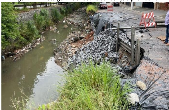
Figura 11. Vista geral do local e contenção provisória.
