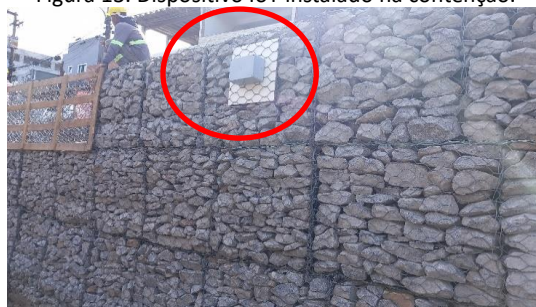
Figura 13. Dispositivo IoT instalado na contenção.
