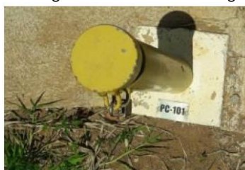
Figura 5. Piezômetro Casagrande instalado na barragem de terra da PCHo.
