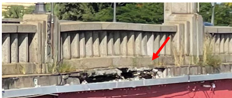
Figura 12: Deslocamento das pedras ornamentais, na fachada da Ponte Princesa Isabel.
