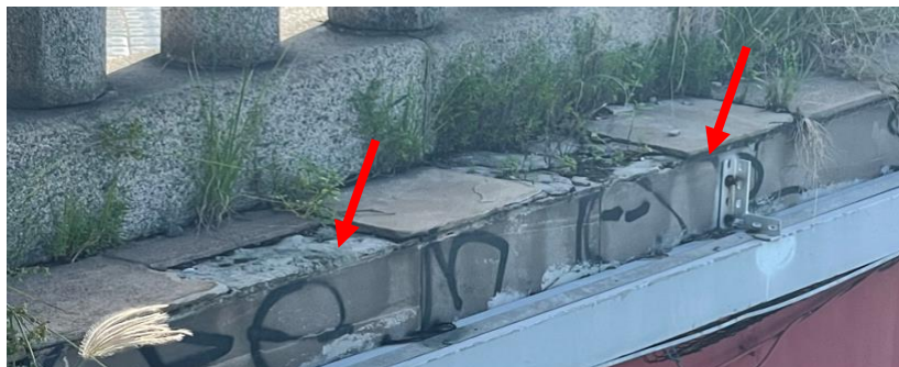
Figura 13: Deslocamento das pedras ornamentais, na fachada da Ponte Princesa Isabel.
