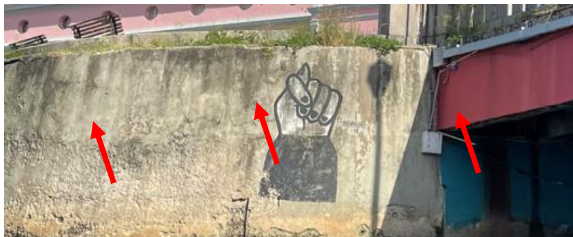
Figura 15: Aparecimento de manchas de umidade na lateral da ponte Princesa Isabel.
