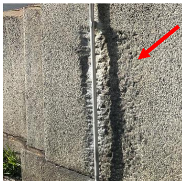
Figura 11: Perda de massa observada no corpo do poste na ponte Santa Isabel.
