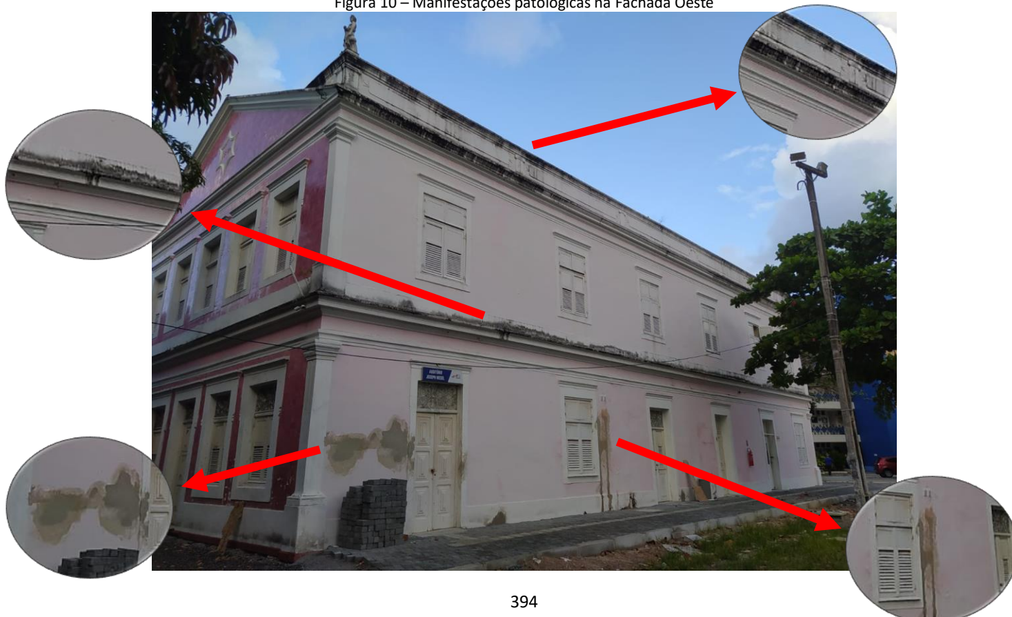
Figura 10 – Manifestações patológicas na Fachada Oeste
