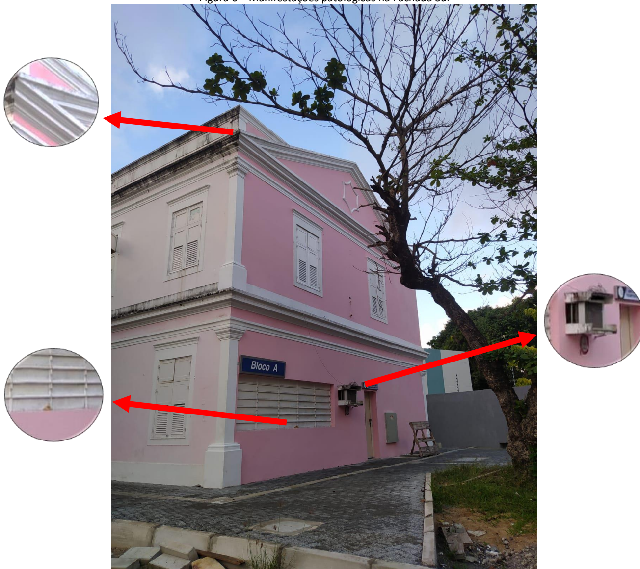
Figura 6 – Manifestações patológicas na Fachada Sul
