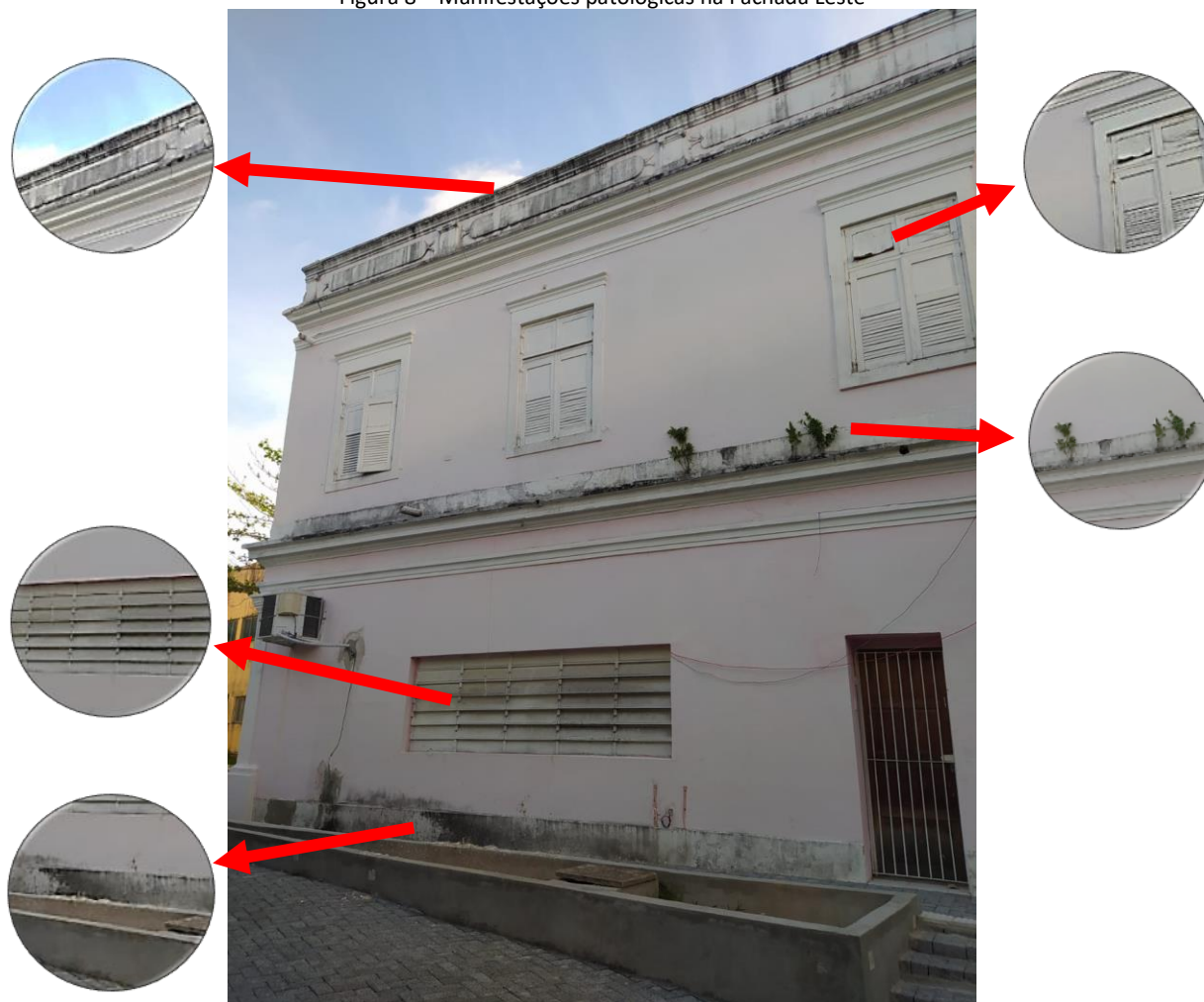
Figura 8 – Manifestações patológicas na Fachada Leste
