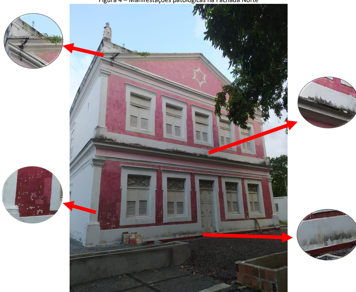
Figura 4 – Manifestações patológicas na Fachada Norte
