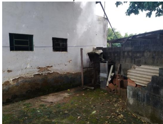
Figura 4 – Acúmulo de entulho e patologias existentes na edificação dos sanitários
