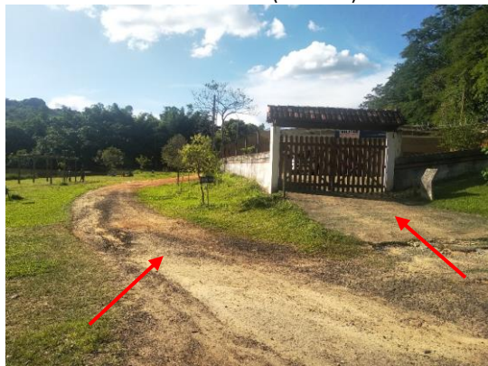
Figura 3 – Falta de manutenção na pista de caminhada (à esquerda) e na rampa de entrada do prédio administrativo (à direita)
