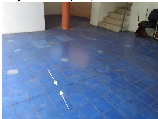
Figura 12 – Deformação do piso interno – térreo
