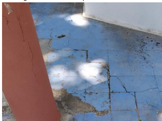
Figura 11 – Fendas no piso externo – térreo
