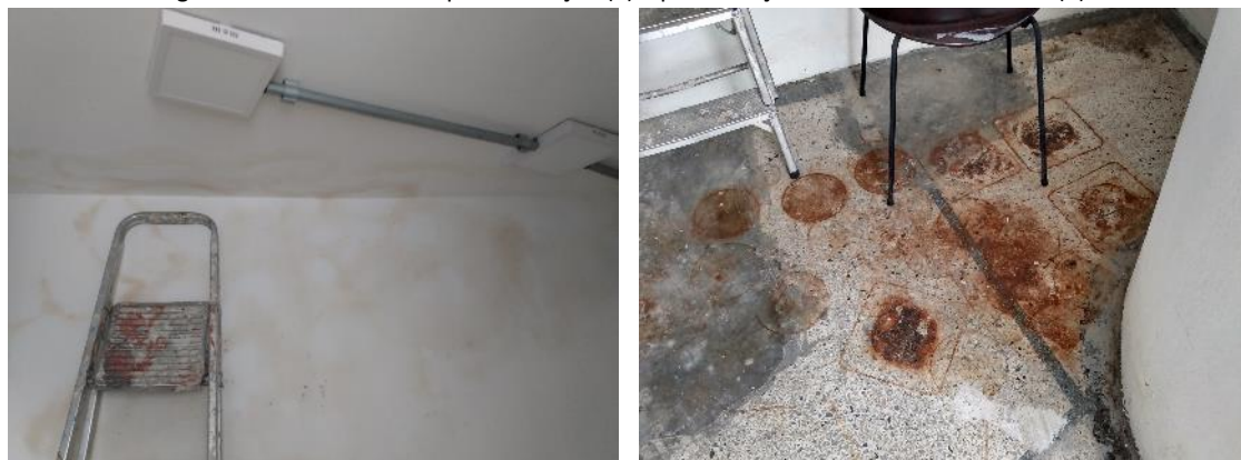
Figura 8 – Manchamentos por infiltração (a) e por oxidação de materiais metálicos (b)
