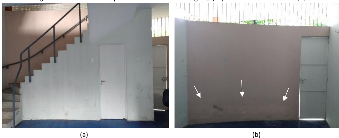
Figura 7 – Manchamentos por fluxo descendente de água (a) e por umidade ascendente (b)
