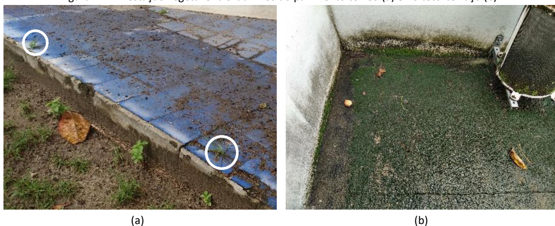
Figura 14 - Infestação vegetal entre ladrilhos do pavimento térreo (a) e no teto-terraço (b)
