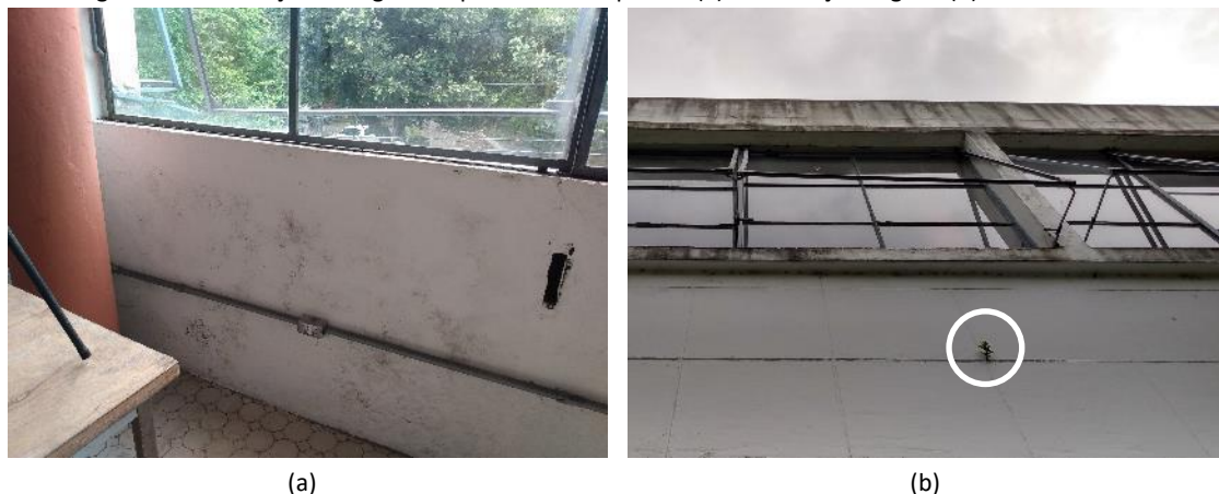
Figura 13 – Infestação biológica em parede sob esquadria (a) e infestação vegetal (b) – fachada leste
