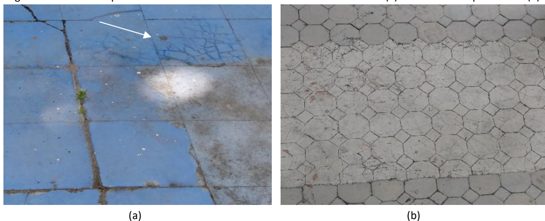
Figura 10 - Fissuras superficiais no ladrilho hidráulico da área externa do térreo (a) e de sala do 1º pavimento (b)
