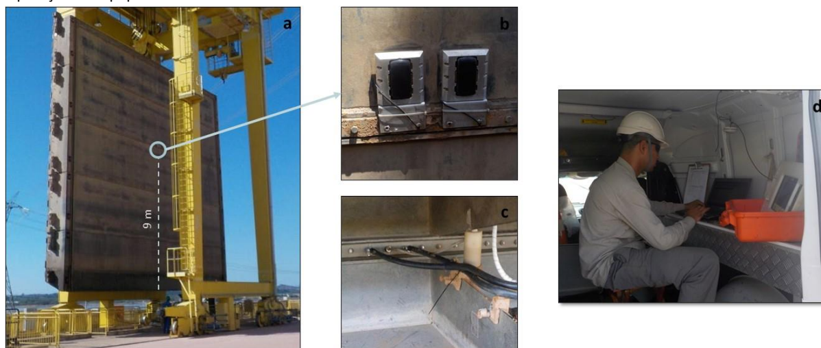
Figura 3 – Sistema hidroacústico acoplado ao plano de face da comporta vagão da UHE Jirau (Patente nº BR 102015000457-5 A2). a – Comporta vagão; b – Detalhe da fixação dos transdutores; c – Detalhe do cabeamento; d – Operação do equipamento hidroacústico.
