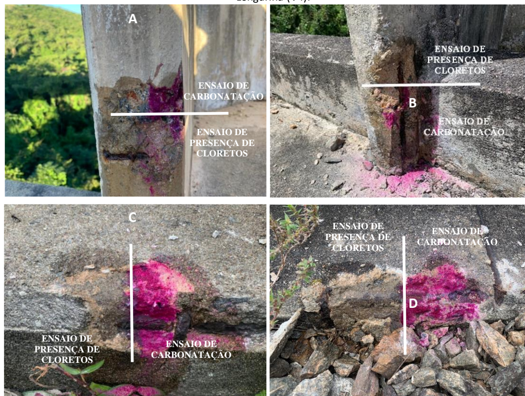
Figura 2 – Ensaio de carbonatação e presença de cloretos: Refúgio V1 (A); Refúgio V6 (B); Longarina (V2); Longarina (V4).
