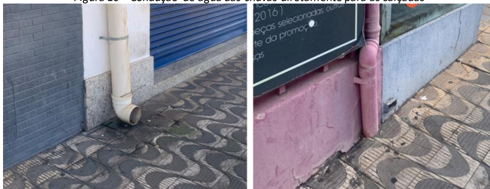
Figura 10 – Condução de água das chuvas diretamente para as calçadas
