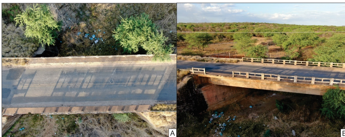
Figura 4 – (A) Ortofoto da Ponte sobre o Riacho Pitombeira (voo automático); (B) Exemplo de foto normal obtida por voo manual na fachada, método adotado nas estruturas da PE-615.
