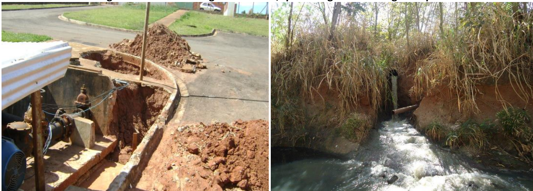
Figura 7: Problemas na bomba de recalque na estação elevatória localizada no Bairro Nova Ilha, e lançamento de esgoto direto no Córrego sem nome, que deságua no Córrego do Ipê.
