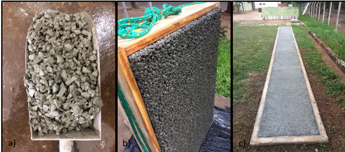
FIGURA 2: a) Concreto permeável em estado fresco; b) Placa de concreto permeável; c) Pavimento experimental em concreto permeável construído nas dependências do Campus 1 da Universidade Estadual Paulista - UNESP, Ilha Solteira - SP
