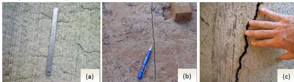
Figura 4 - Diferença de dimensão entre uma fissura (a), uma trinca (b) e uma rachadura (c)
