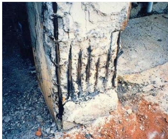
Figura 6 - Corrosão de armadura em pilar de concreto armado
