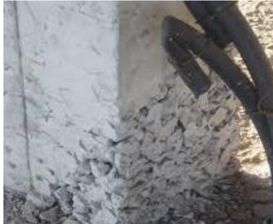
Figura 7 - Desagregação do concreto
