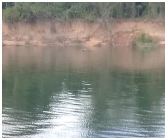
Figura 3: Processo erosivo na margem esquerda do rio Tocantins.
