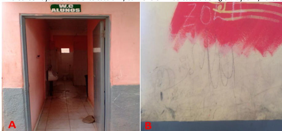
Figura 14 – Má Conservação do ambiente escola. A) banheiro em mau estado de higienização. B) Paredes pinchadas
