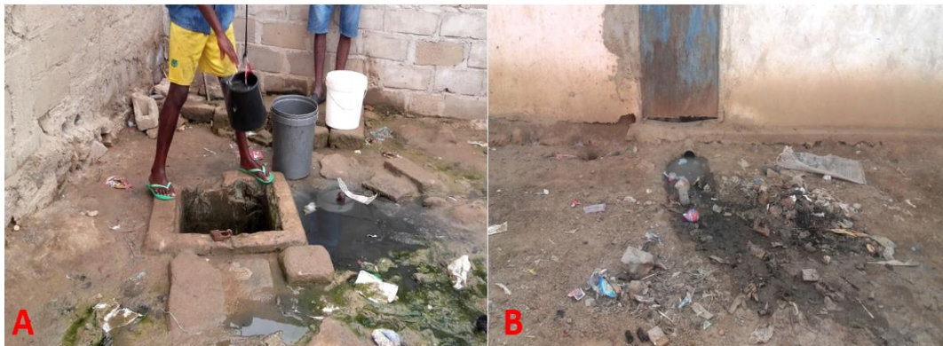
Figura 11 – Condições de saneamento do bairro. A) poço público em péssimo estado de conservação, usado para extração de água de consumo da população. B) esgoto a céu aberto defronte ao portão de uma residência
