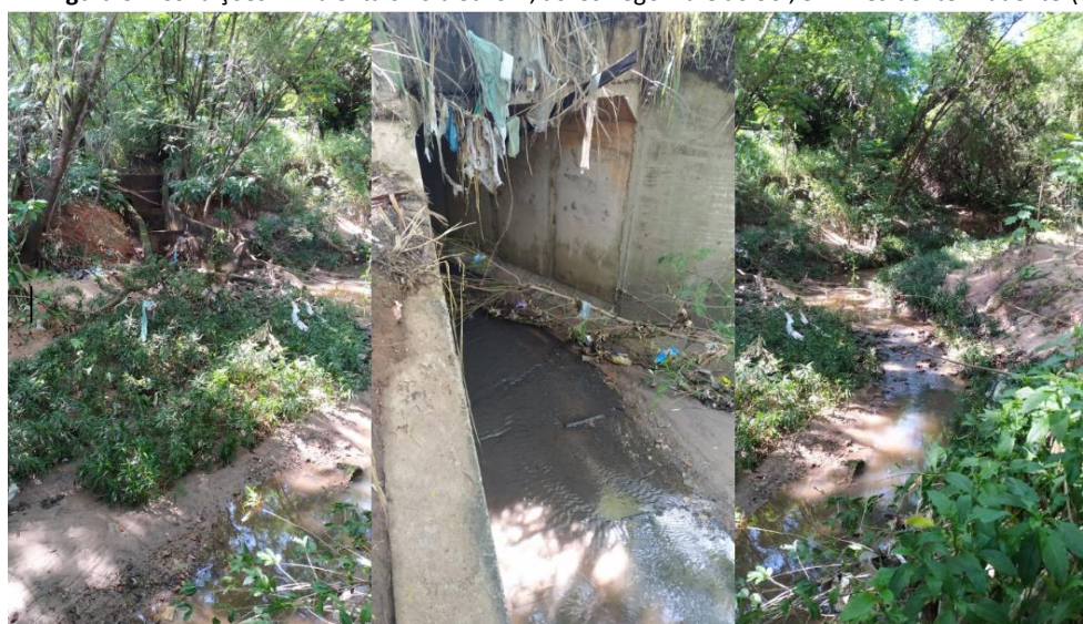
Figura 3 – Condições Ambientais no trecho 1, do Córrego Vale do Sol, em Presidente Prudente (SP).
