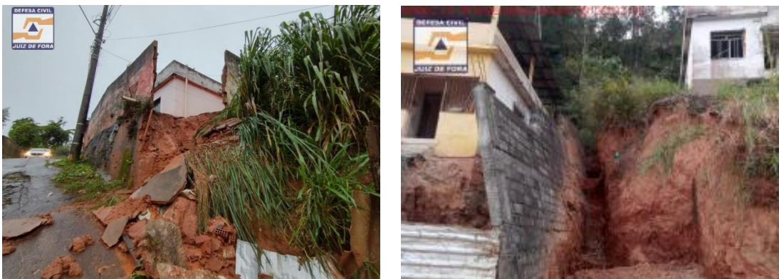
Figuras 18 e 19 - Desabamento de muros de contenção.
