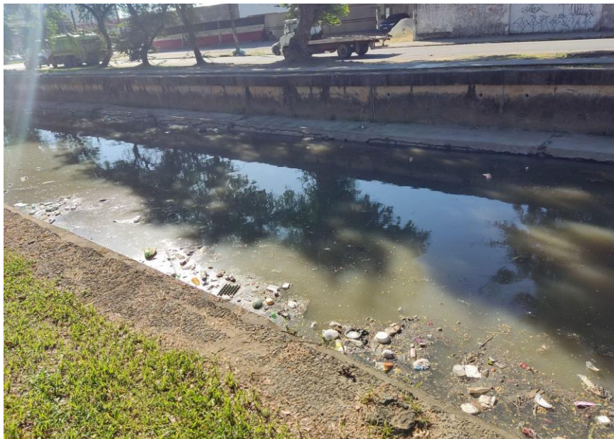
Figura 3 – Acúmulo parcial de resíduos em trecho do Canal do Arruda
