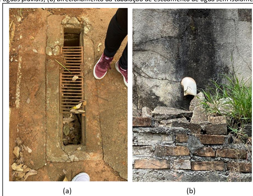
Figura 3 – Vista parcial das canalizações nas dependências do Cemitério (São Paulo, SP): (a) Canal para escoamento de águas pluviais; (b) Direcionamento da tubulação de escoamento de água sem isolamento.
