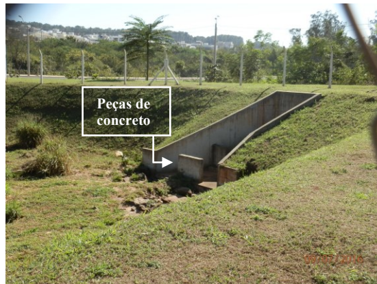
Foto 8: Bacia 1 – Dissipador 2 de energia na estrutura de entrada de água
