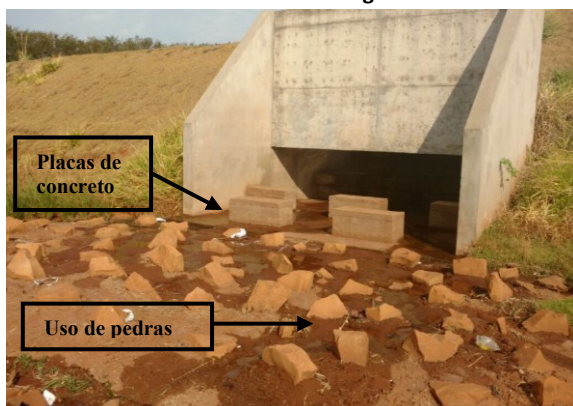
Foto 15: Bacia 2 – Dissipadores de energia estruturas de entrada de água
