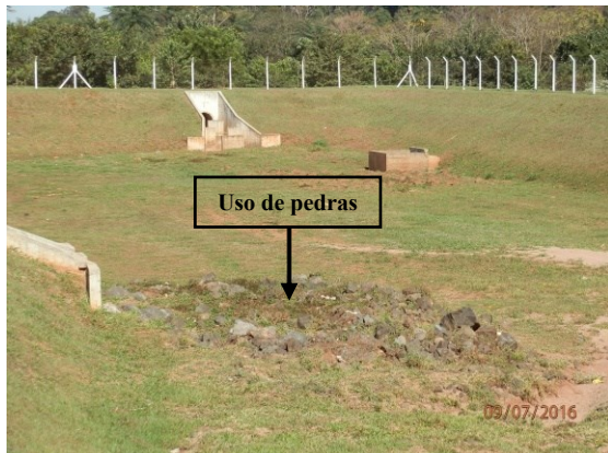
Foto 7: Bacia 1 – Dissipador 1 de energia na estruturas de entrada de água
