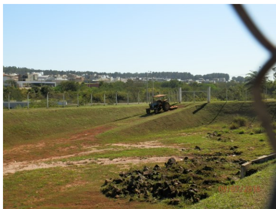
Foto 5: Bacia 1 – Equipamento para manutenção
