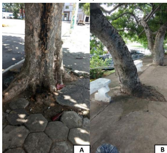
Figura 5: A – Árvore com raízes danificando a calçada; B – Árvore com ausência de área livre.
