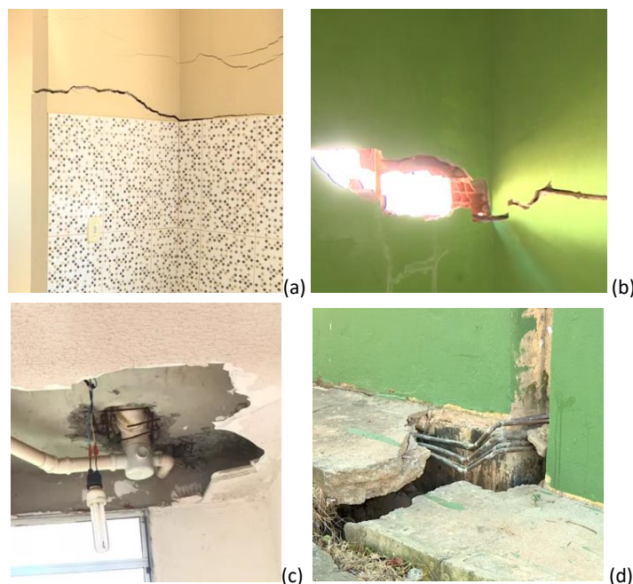
Figura 8 – Problemas estruturais: (a) rachadura, (b) estrutura comprometida, (c) infiltração, (d) recalque diferencial.
