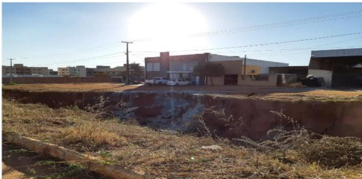
Fotografia 2 – Erosão antes das obras de revitalização
