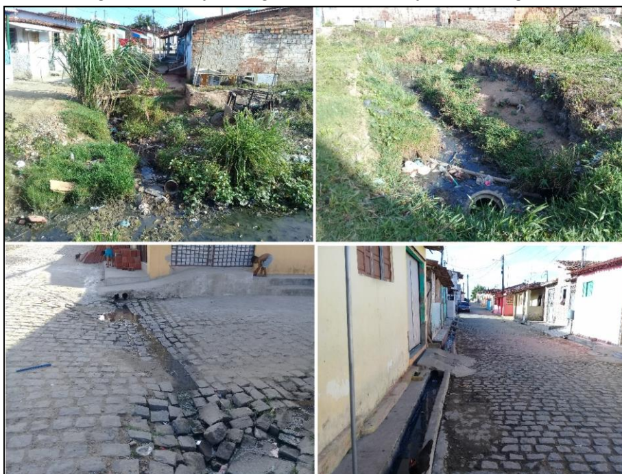
Figura 6 – Tubulações e Esgotos Diretamente Lançados no Córrego
