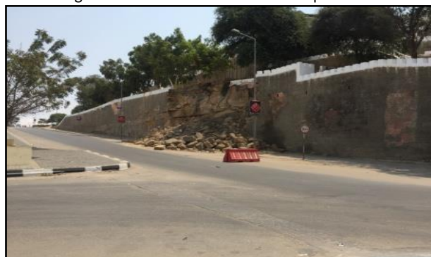
Figura 7 - Zona Lateral da Fortaleza que cedeu
