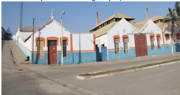
Figura 1 - Armazéns em avançado estado de Degradação (Zona Histórica de Moçâmedes), 2014
