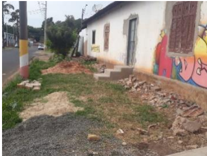
Figura9 – Ausência de calçadas e presença de entulhos Quadra F2.
