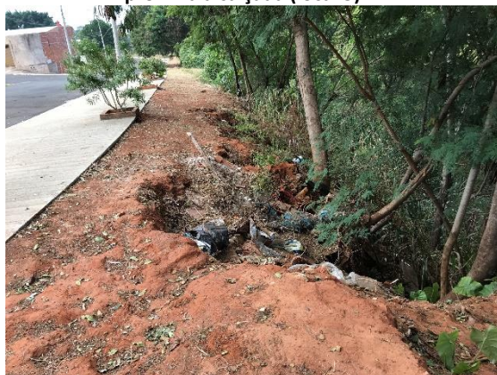
Figura 10 – Feiçõs erosiva em desenvolvimento próxima à calçada (local 5).
