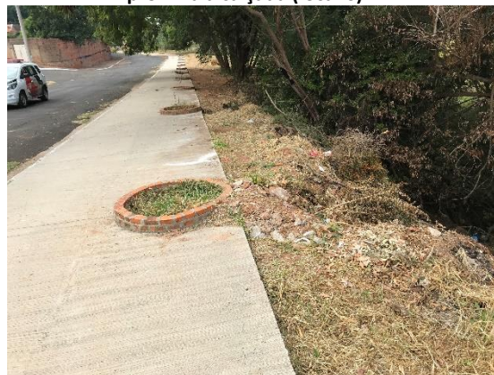
Figura 11 - Feiçõs erosiva em desenvolvimento próxima à calçada (local 6).
