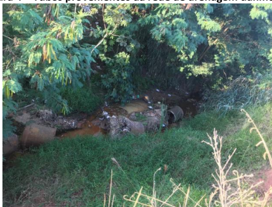
Figura 4 – Tubos provenientes da rede de drenagem danificada.
