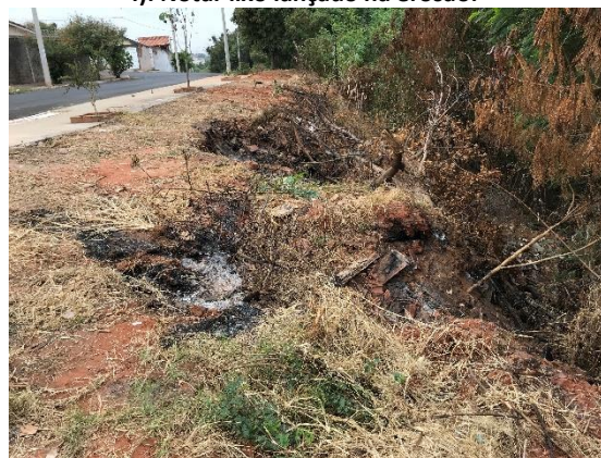
Figura 9 – Feiçõs erosiva em desenvolvimento (local 4). Notar lixo lançado na erosão.
