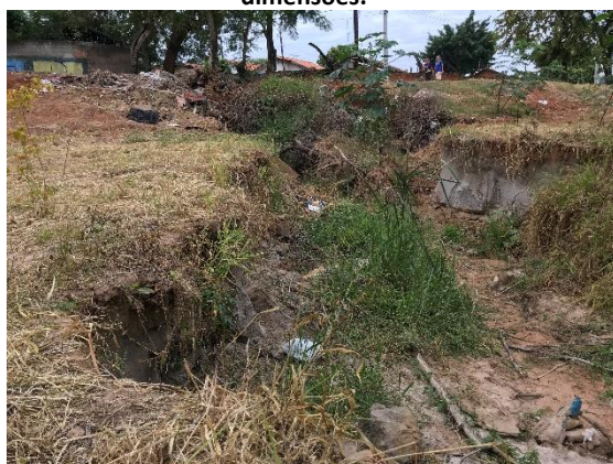
Figura 8 – Feiçõs erosiva em desenvolvimento (local 2). Notar lixo lançado na erosão e grandes dimensões.
