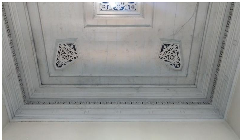
Figura 13: Forro com marca de sujidade e mofo.
