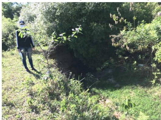
Figura 14 – Erosão de margem no canal de drenagem.
