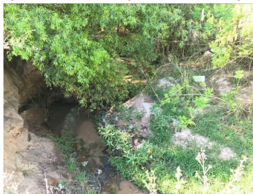
Figura 15 – Erosão de margem no canal de drenagem.
