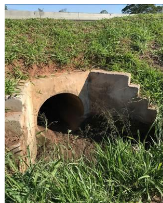
Figura 7 – Tubulação de drenagem com acúmulo de sedimentos.
