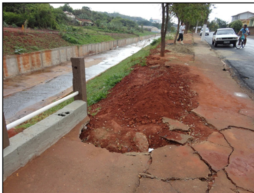
Figura 5. Processo Erosivo do lado da canalização do Córrego do Jaboticabal. Acervo pessoal, 2012.
