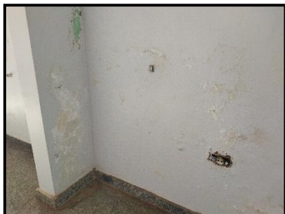
Figura 3F – Infiltração e Instalação antiga
