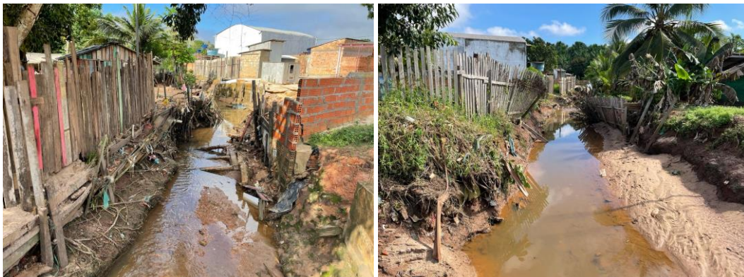
Figura 2 – Trechos estreitados do Igarapé devido ao assoreamento e ocupação irregular no Bairro da Liberdade.
