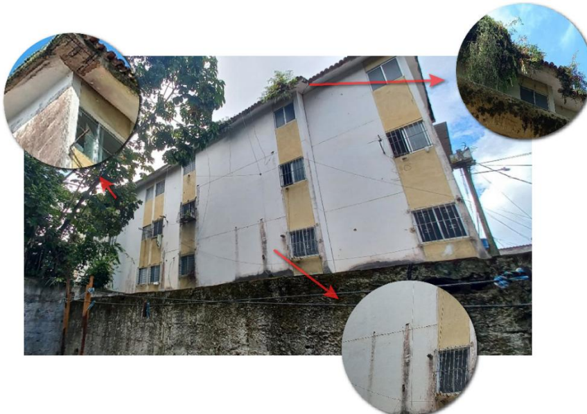
Figura 8 - Manifestações patológicas da fachada norte do Bloco 89
