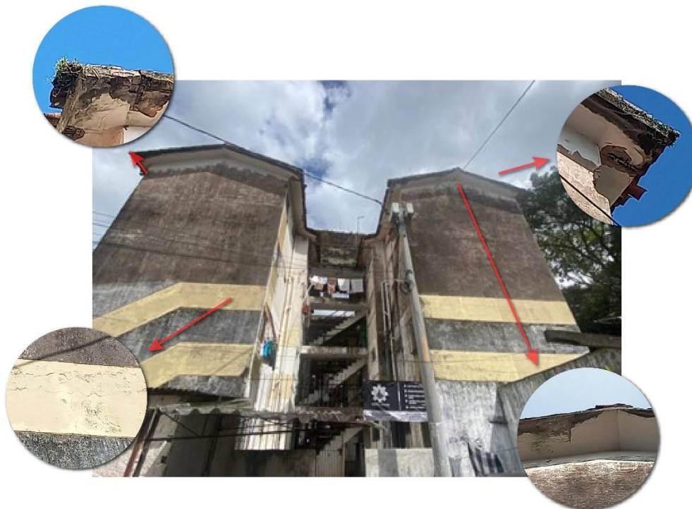
Figura 4 – Manifestações patológicas da fachada leste do Bloco 89
