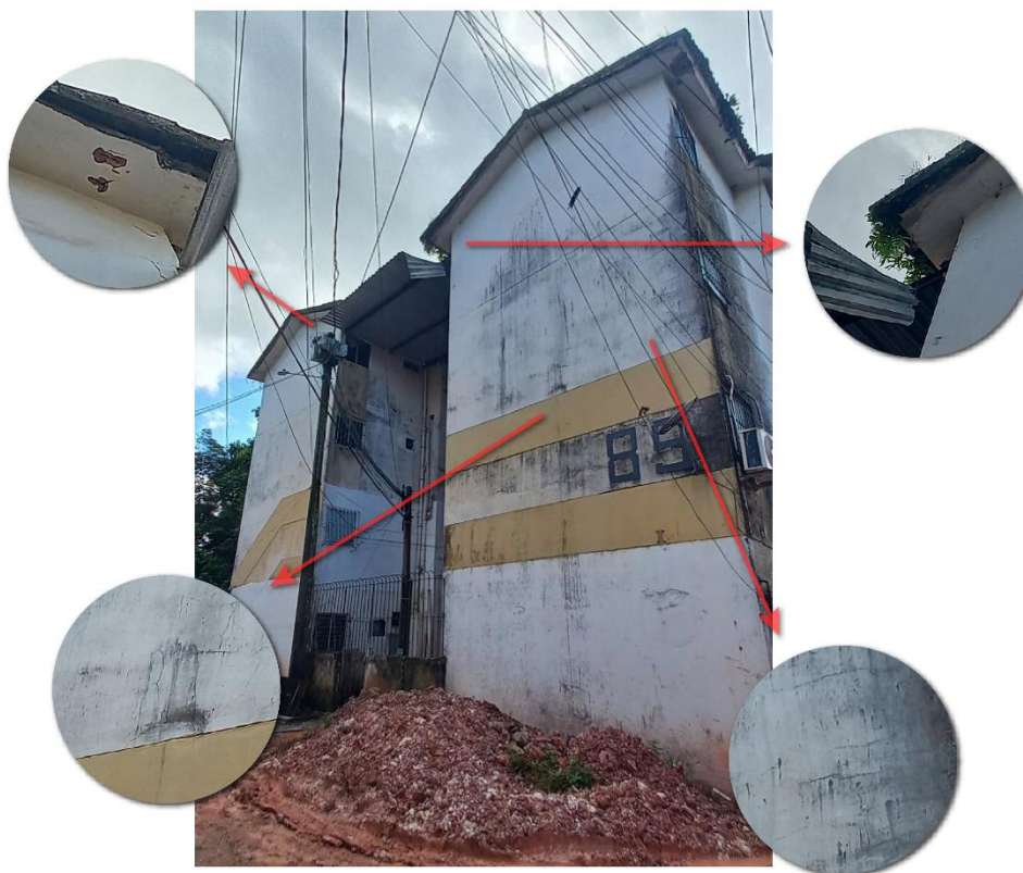
Figura 2 – Manifestações patológicas da fachada oeste do Bloco 89
