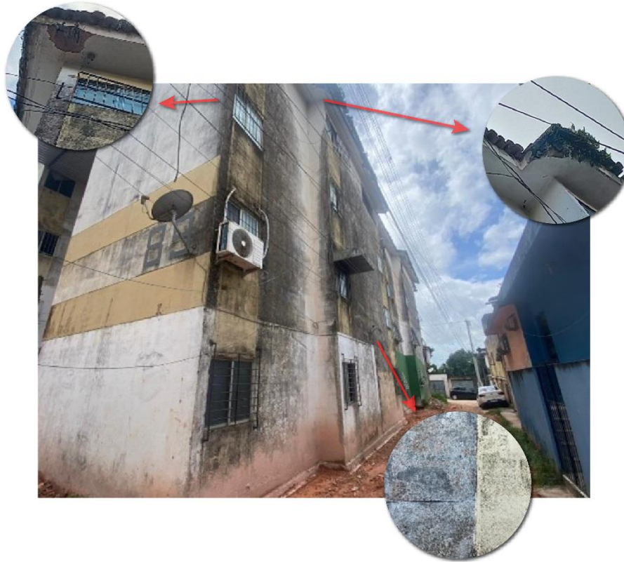
Figura 6 – Manifestações patológicas da fachada sul do Bloco 89
