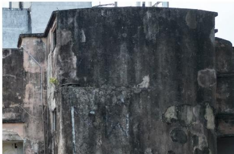
a) Detalhe retirado da fachada norte, mostra sujidade e crosta negra em grande parte da fachada.
