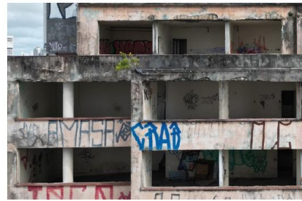
b) Detalhe retirado da fachada sul, mostra a presença de corrosão da armadura em grande parte do edifício.
