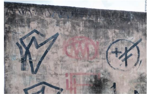
b) detalhe retirado da fachada norte, mostra sujidade e crosta negra em grande parte da fachada.
