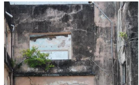
d) Detalhe retirado da fachada norte, mostra a presença de vegetação.
