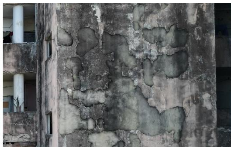
c) Detalhe retirado da fachada norte, mostra a presença de deslocamento de concreto.
