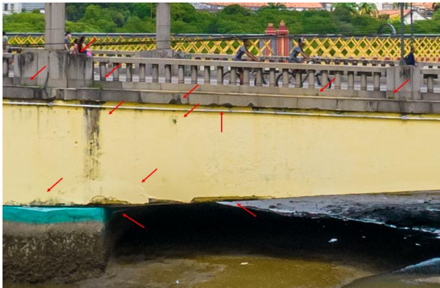
Figura 10 – Manifestações Patológicas da face do primeiro tramo da Ponte Duarte Coelho, sentido ponte de Princesa Isabel.
