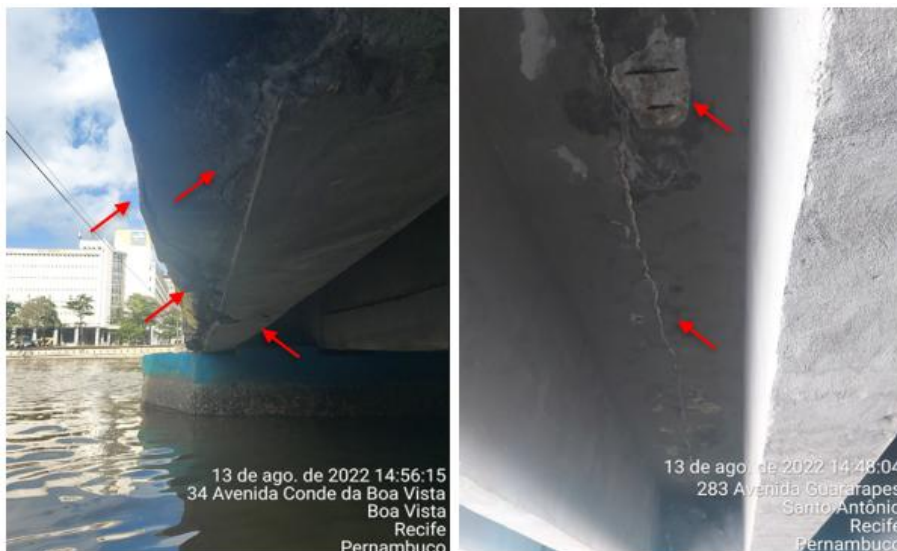
Figura 12 – Deslocamento, corrosão, fissura e eflorescência da estrutura no primeiro tramo da Ponte Duarte Coelho.
