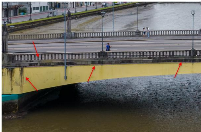
Figura 15 – Sujidades, mofo e bolor na face do segundo tramo da Ponte Duarte Coelho, sentido Ponte de Ferro.
