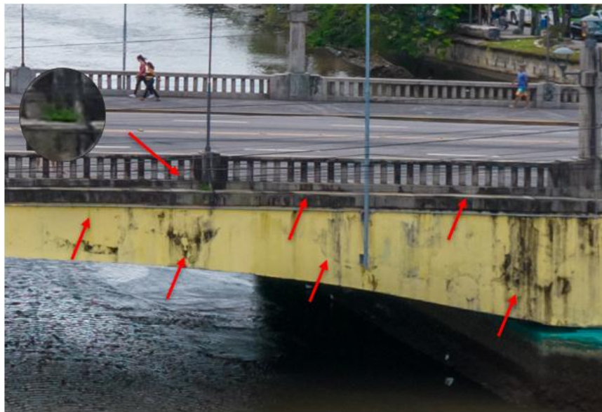
Figura 14 – Sujidades, vegetação, mofo e bolor na face do segundo tramo da Ponte Duarte Coelho, sentido Ponte de Ferro.
