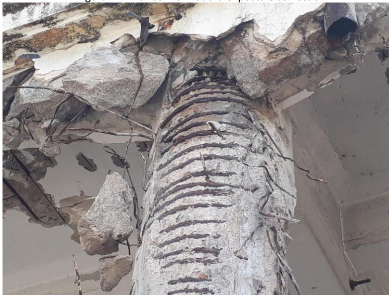
Figura 7 – Pilar com armadura exposta e corrosão
