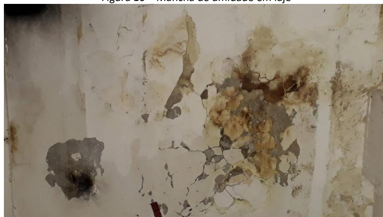
Figura 10 – Mancha de umidade em laje
