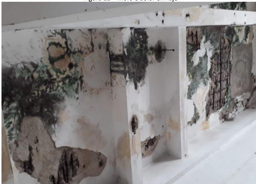
Figura 12 – Mofo e bolor em laje
