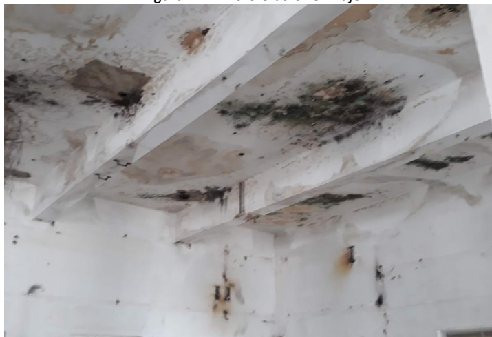
Figura 11 – Mofo e bolor em laje
