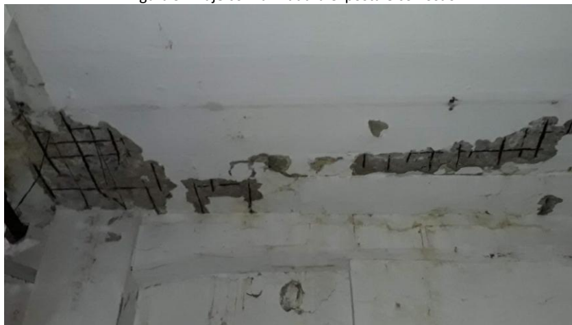
Figura 9 – Laje com armadura exposta e corrosão
