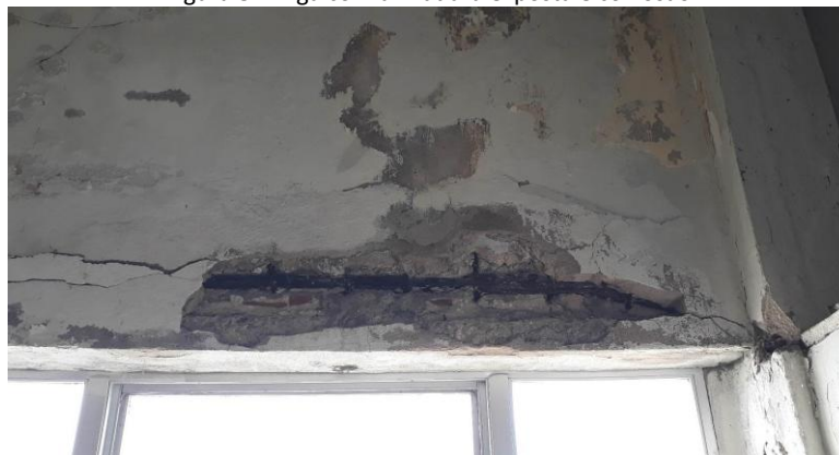
Figura 8 – Viga com armadura exposta e corrosão
