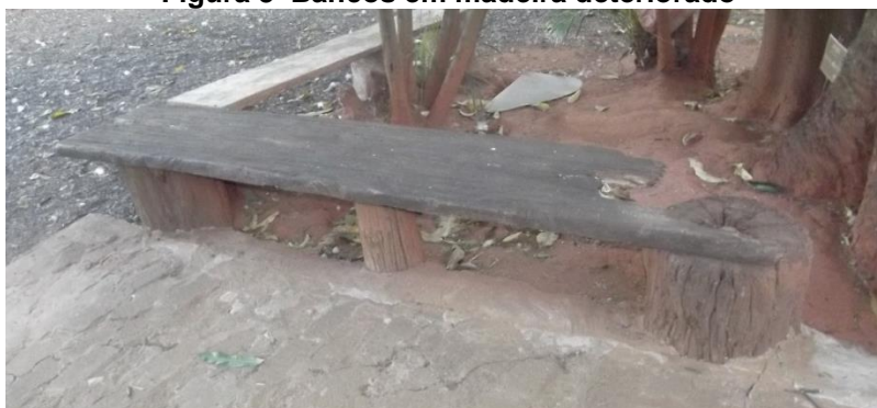
Figura 3- Bancos em madeira deteriorado
