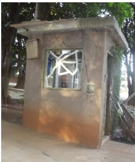
Figura 2- Instalações físicas do Parque com estruturas descuidadas. No detalhe, janela de vidro quebrada.
