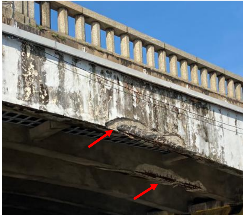
Figura 7 – Desagregação de material na fachada e na parte inferior da Ponte Santa Isabel em 2021
