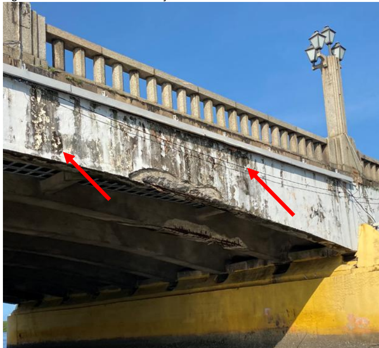
Figura 5 – Pontos de biodeterioração na fachada da Ponte Santa Isabel em 2021
