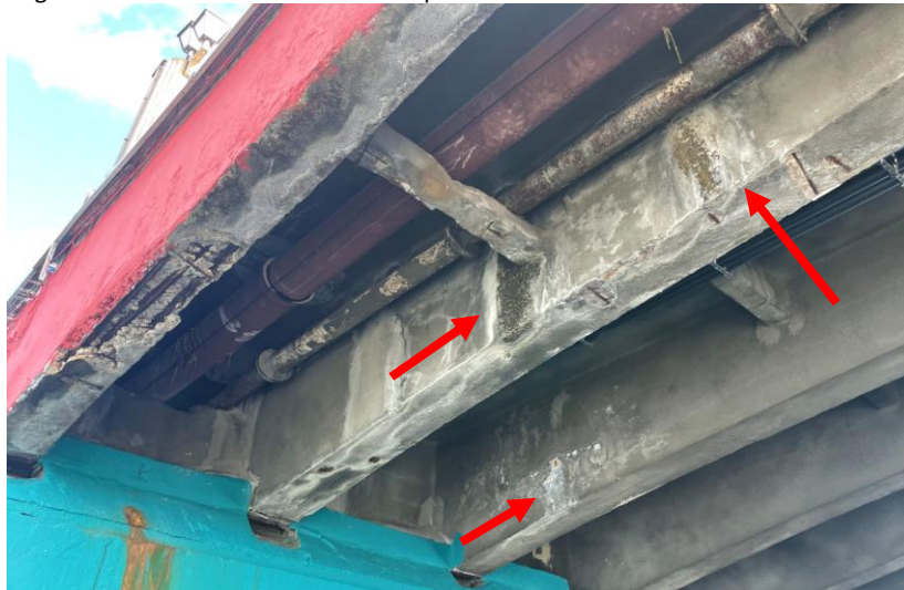
Figura 6 – Pontos de eflorescência na parte inferior da Ponte Santa Isabel em 2022
