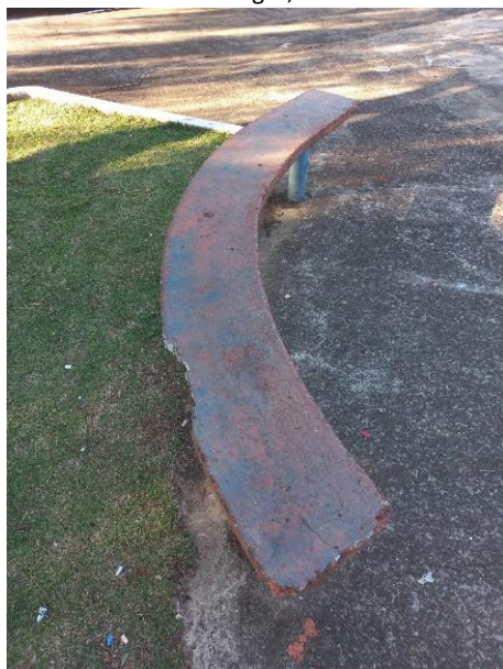
Figura 2 – A – Banco de concreto e exemplo de deterioração encontrados na Praça do Estudante, Jardim Alegre, Paraná
