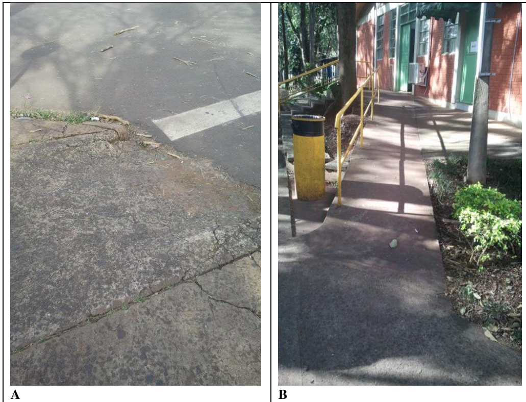
Figura 4: Rampas com inclinação a cima do permitido e sem sinalização adequada
