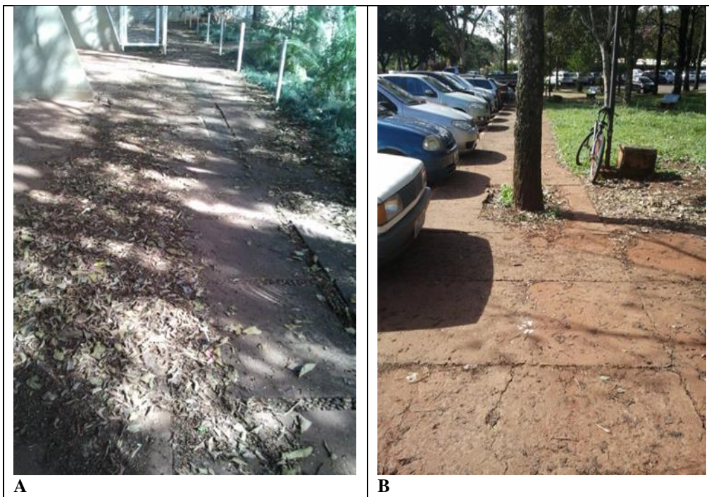
Figura 02: Pavimentação degradada com presença de vegetação arbórea no calçamento.
