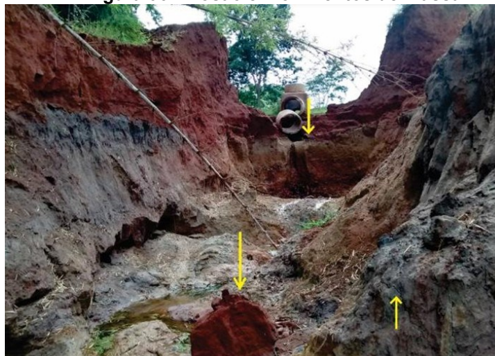
Figura 06: Erosão e movimentos de massa
