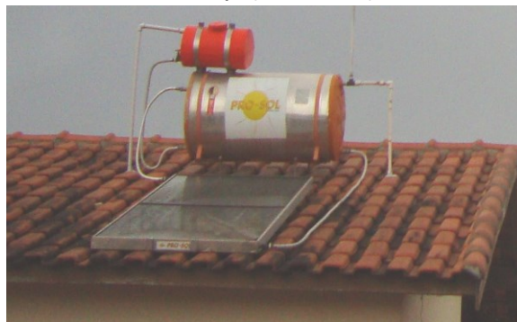
Figura 5: Sistema solar de aquecimento de água da PRO-SOL instalado em residência do Conjunto Nova Tupã (Jamil Dualib).
