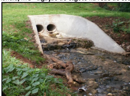
Figura 12: Uberlândia/MG - Ligação de esgoto na rede de escoamento pluvial
