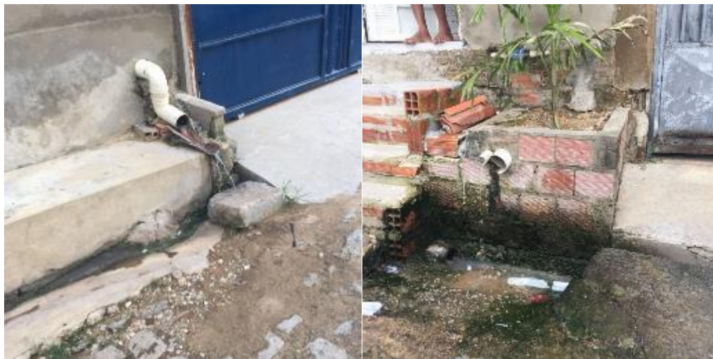
Figuras 8 e 9 – Despejo de esgoto nas vias de circulação do aglomerado.
