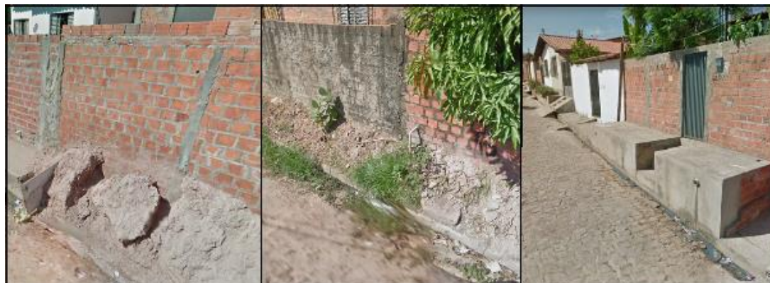
Figura 4 – Calçadas ausentes, não conservadas e intrafegáveis, respectivamente.
