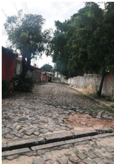
Figura 5 – Pavimentação poliédrica com patologia.
