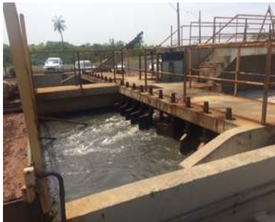
Figura 8: Desarenador da ETE de Votuporanga
