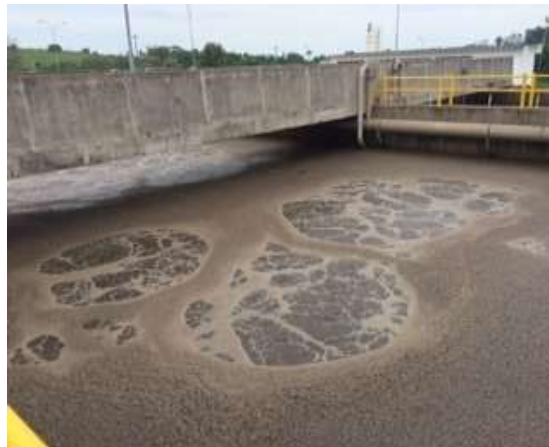
Figura 16: Tanques de aeração prolongada
