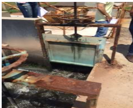
Figura 12: Corrosão de elementos metálicos do sistema de tratamento preliminar
