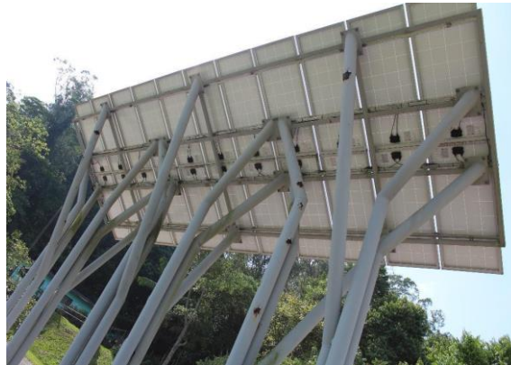
Figura 8 - Parte Inferior da infraestrutura do sistema solar fotovoltaico
