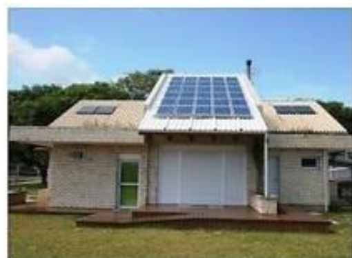
Figura 2: Sistema fotovoltaico concomitante
