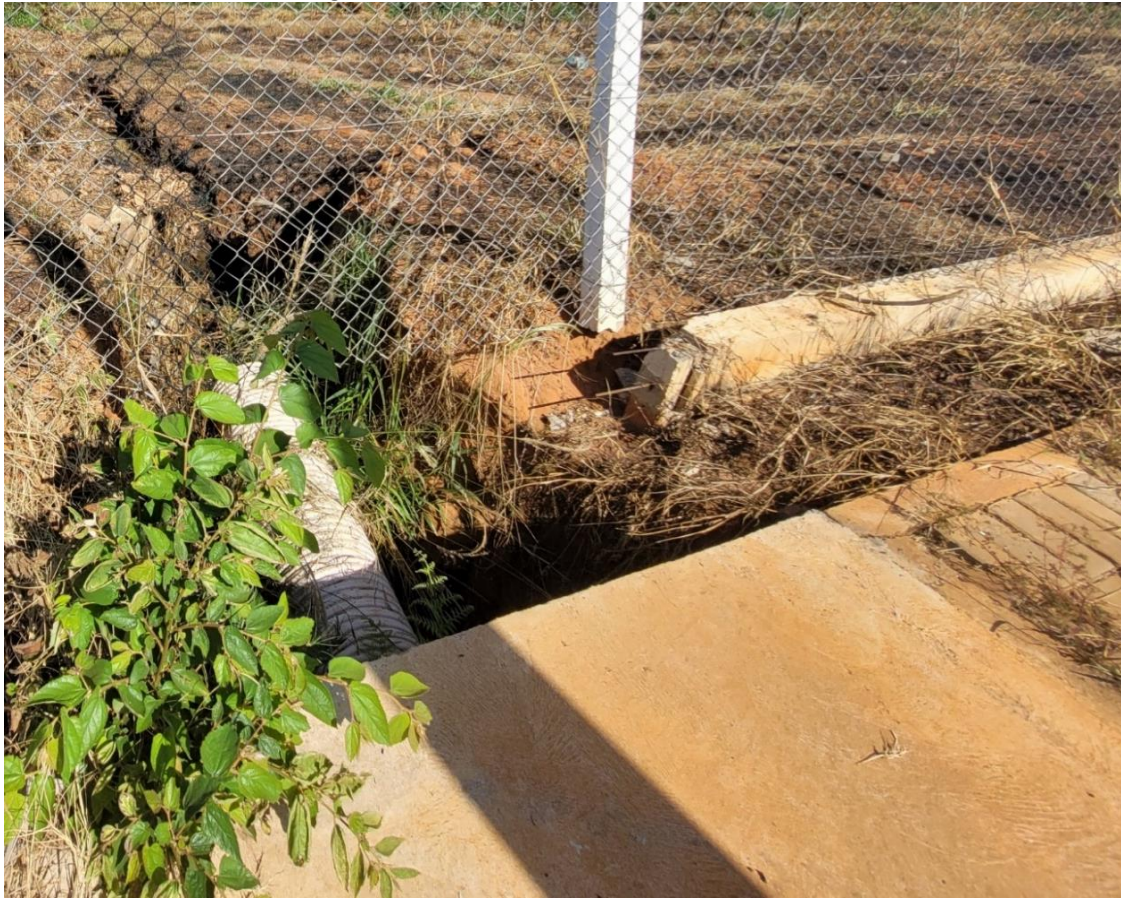
Figura 5 – Marcas de queimadas e marca de erosão
