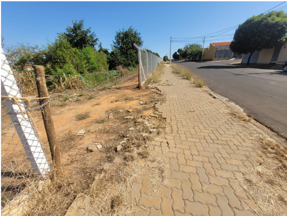
Figura 6 – Complemento de alambrado feito com cerca de arame e fechamento de cadeado, ao longo da calçada deteriorada
