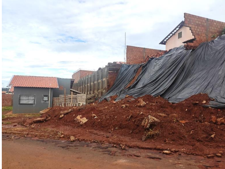
Figura 8 – Uberaba-MG: Alfredo Freire IV – Danos causados por chuvas (2023)
